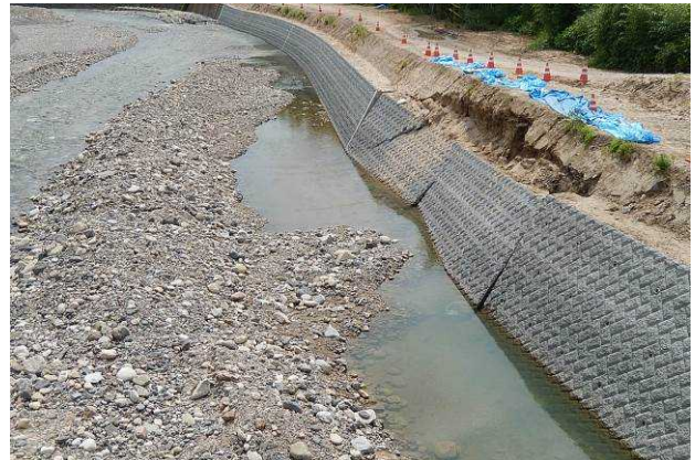
図－19 施工済区間における被災状況
