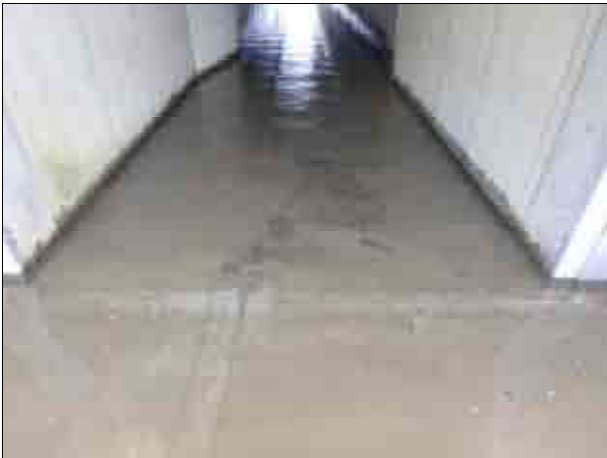
写真-9 全閉前の土砂堆積状況
