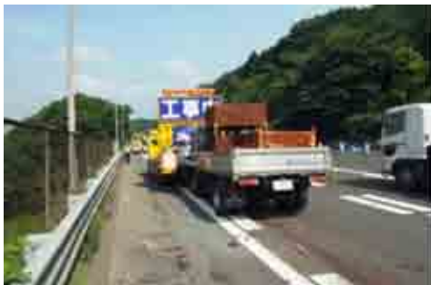
写真-5 規制内進入事故例
