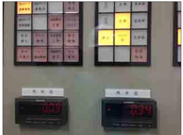
写真-12 盤面内・外水位表示
