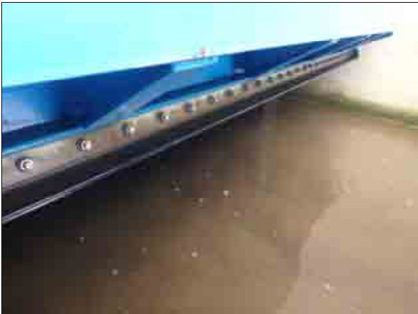
写真-15 フラップ後の水密ゴム状況 ゴムの剪断、破断は起こっていない。
