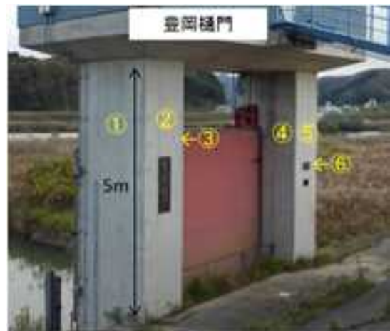
図5 門柱傾倒面計測位置
