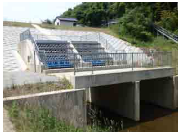
写真-2 引き上げ式門柱レスゲートの一般外観
