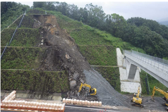
図-1 紀勢自動車道荒堀地区の崩壊事例
