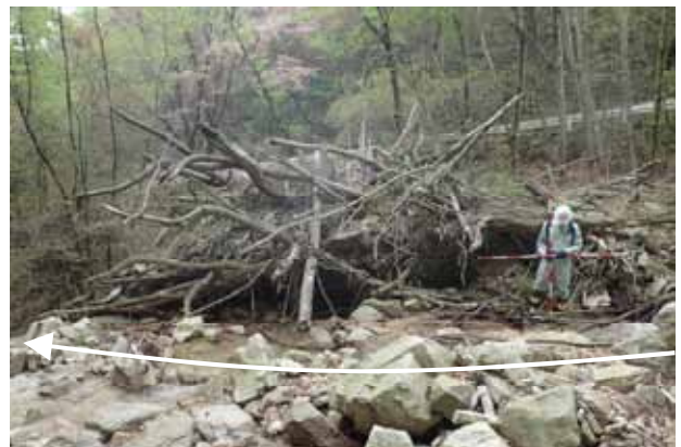
写真-4 堰堤右袖の直上流に異常堆積した流木と土砂
