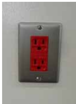
図4-7 非常用コンセント
