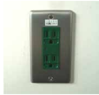
図4-8 自立運転コンセント
