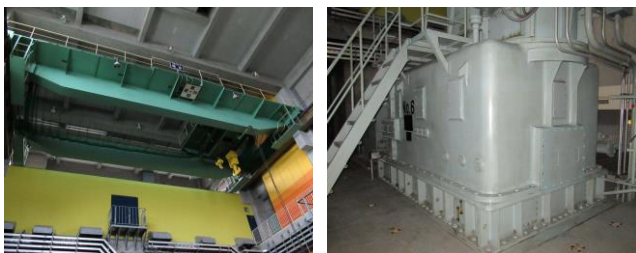
60 t 吊天井クレーン
