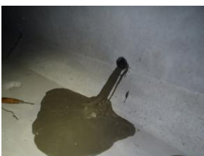
写真21-側部湧出確認
