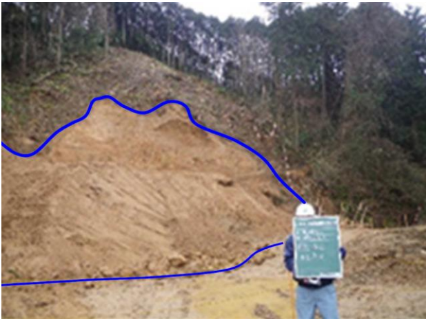
写真-1 坑口部崩落
