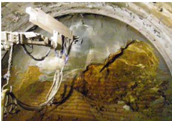
写真-4 支保No.39での切羽崩落状況
