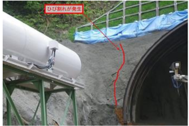
写真-2 坑口部ひび割れ
