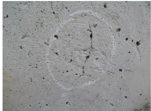
写真-2 充填不足箇所
