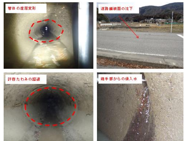
図-2 変状状況写真
