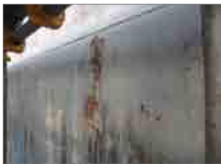
写真6 塗装のはがれ(H28) (G面 下段扉背面)
