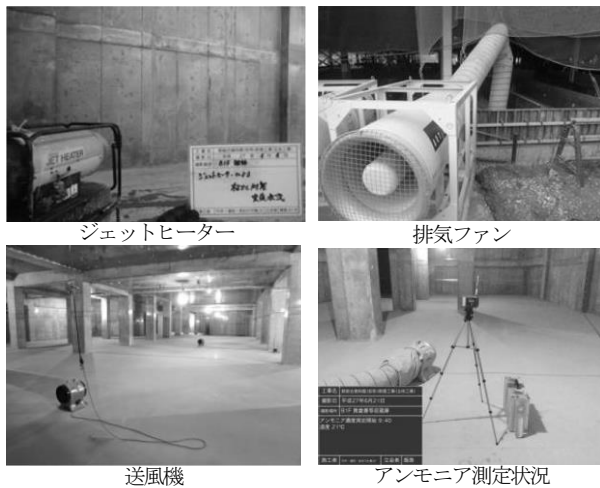
図5. 送風機等設置状況
