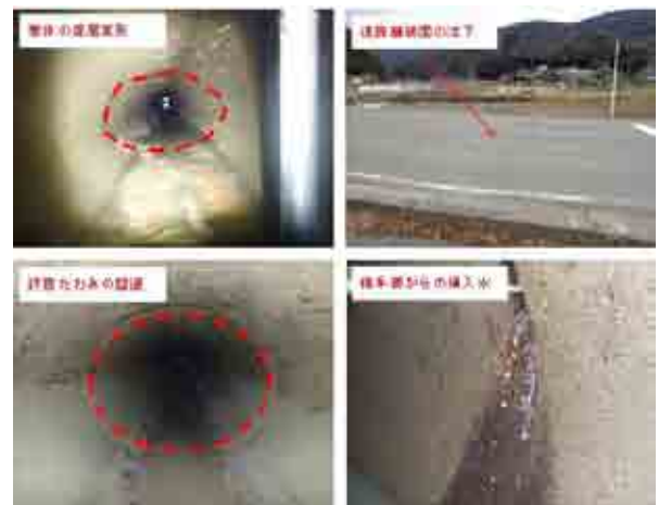
図-2 変状状況写真
