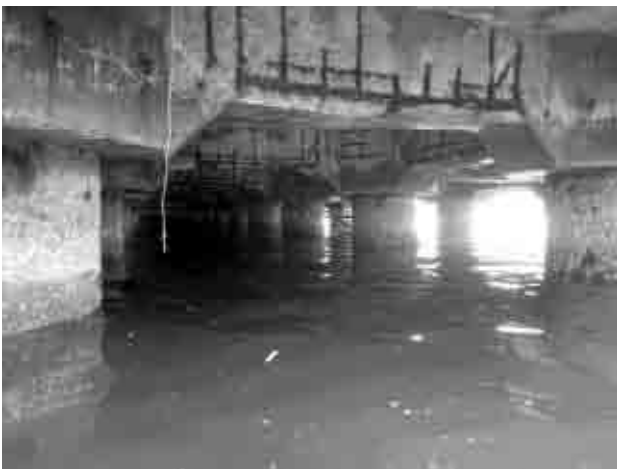
写真-1 汐見3号岸壁 栈橋下部の劣化状況
