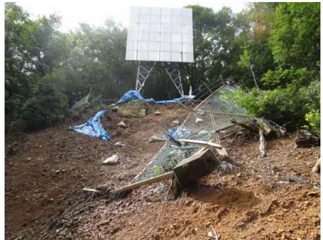
写真-1 猿谷ダム反射板被害状況
