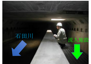
写真7-石田川1号幹線 流入施設
