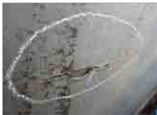
写真5 塗装のわれ(H28) (G面 下段扉背面)
