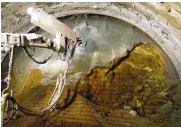
写真-4 支保No.39での切羽崩落状況
