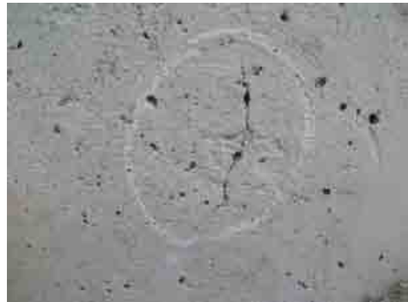
写真-2 充填不足箇所
