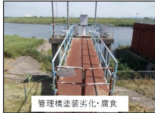
図-7 塗装劣化・腐食 健全度評価△3
