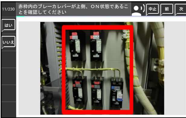
写真3 電源投入確認シナリオ
