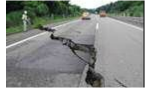
写真-10 切盛境の亀裂による段差(中越沖地震) 7)
