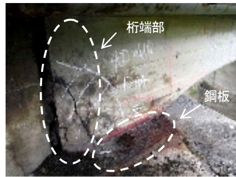
写真-1 コンクリート桁端部付近の損傷状況
