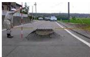
写真-5 埋設物の浮上による段差(中越沖地震) 4)
