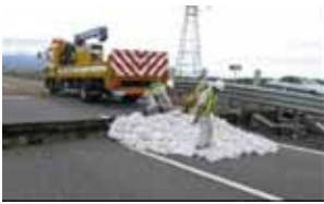
写真-2 橋台部の段差(中越沖地震) 7)
