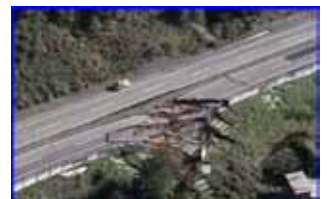
写真-12 沢地形部の盛土の崩壊(中越地震)
