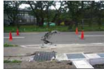
写真-8 地盤の隆起による段差(中越沖地震) 4)
