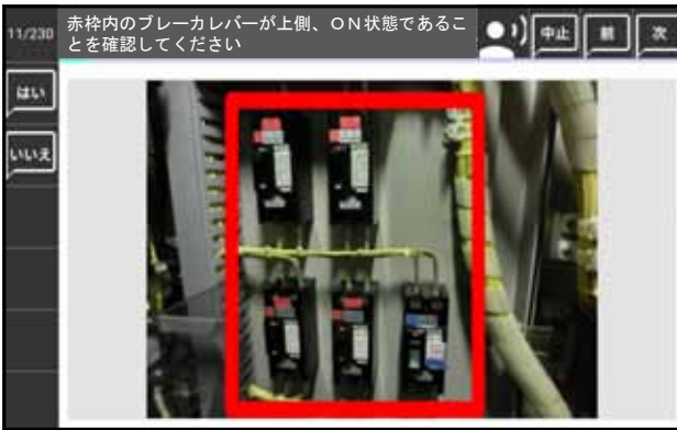
写真3 電源投入確認シナリオ
