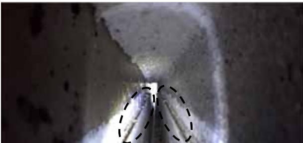
写真-9 止水材の縁切れ状況（破線）
