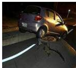
写真-7 液状化地盤の沈下による段差(中越地震)
