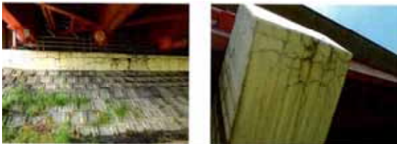
写真-2 京見橋におけるコンクリート損傷事例
