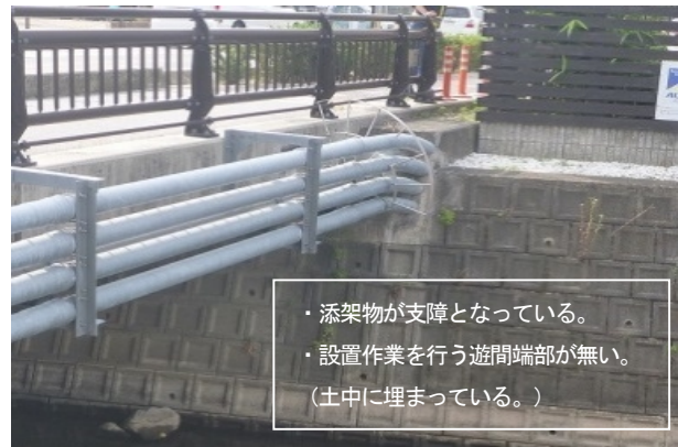
写真-5 簡易排水装置の施工が困難な状況
