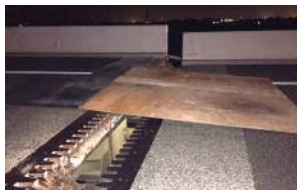
写真-4 橋梁伸縮装置部の段差(熊本地震) 8)
