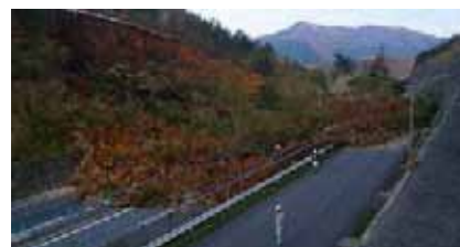
写真-13 切土の崩壊(熊本地震) 8)
