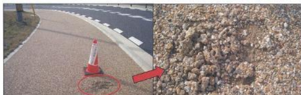
歩道舗装のポットホール
