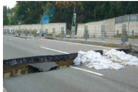
写真-3 C-Box部の段差(中越地震) 9)
