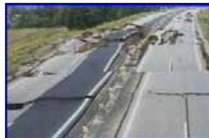
写真-11 盛土の崩壊(中越地震)
