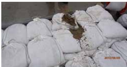
写真-19 スタックにより破断した従来土のう
