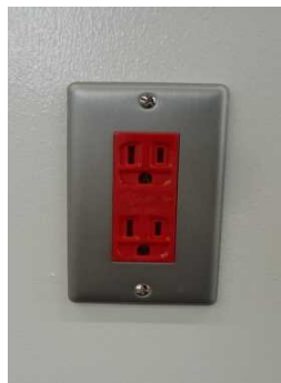
図4-7 非常用コンセント
