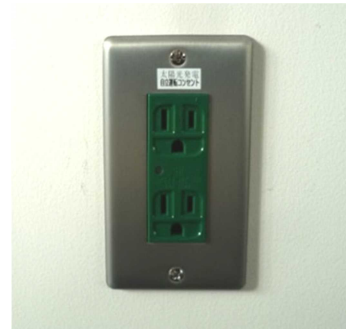
図4-8 自立運転コンセント
