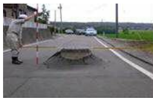
写真-5 埋設物の浮上による段差(中越沖地震) 9)
