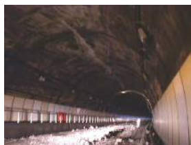
写真-15 トンネル覆工の破壊(中越沖地震) 7)
