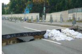
写真-3 C-Box部の段差(中越地震) 9)
