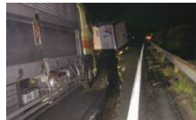
写真-9 亀裂による段差(熊本地震) 8)
