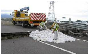
写真-2 橋台部の段差(中越沖地震) 7)
