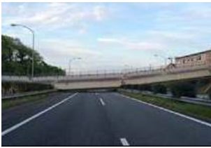
写真-14 落橋 (熊本地震) 6)
