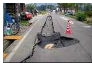
写真-6 埋設物の沈下による段差(中越地震) 6)
