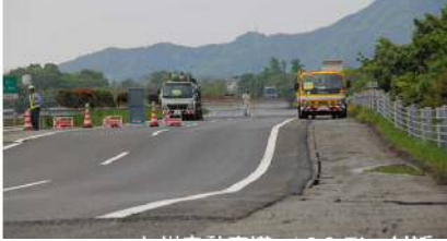
写真-1 路面のうねり(熊本地震) 8)
