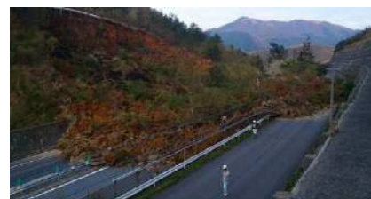
写真-13 切土の崩壊(熊本地震) 8)
