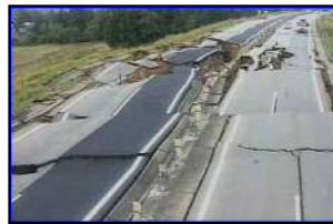
写真-11 盛土の崩壊(中越地震)
