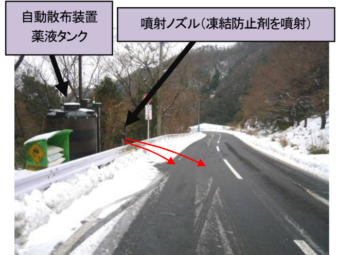
写真-1 凍結防止剤散布装置の設置状況（県道）
