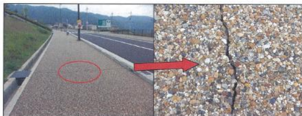
歩道舗装のひび割れ
