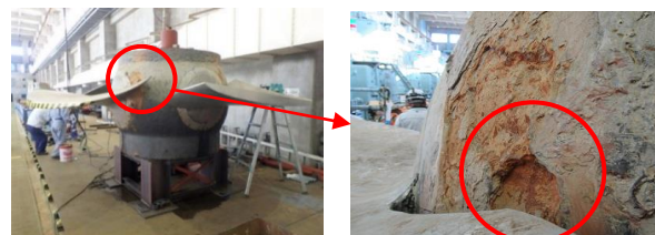
写真-6 ポンプインペラハブ腐食状況
