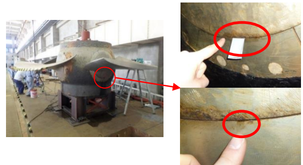
写真-1 ポンプインペラハブ漏油状況 2)
