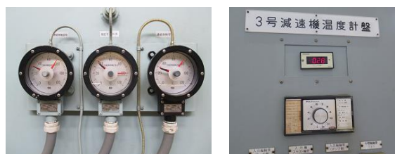
写真-3 電動機付き温度計及び減速機温度計盤
