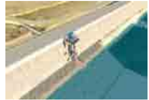
図-11b 樋門不具合
