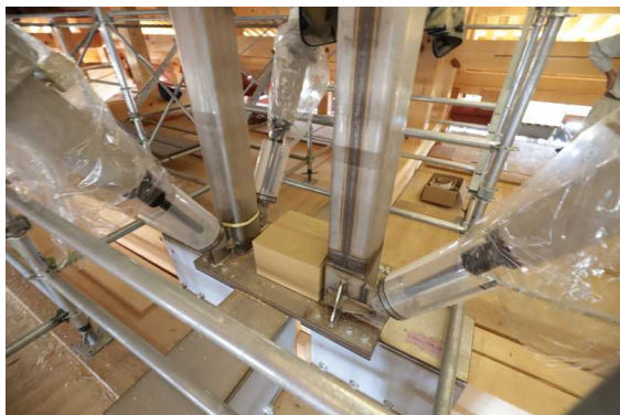
図-8 制振装置の設置状況(2020年(令和2年)5月撮影)
