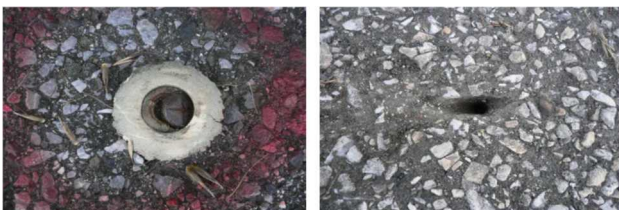
写真-7 損傷・亡失した4級基準点
