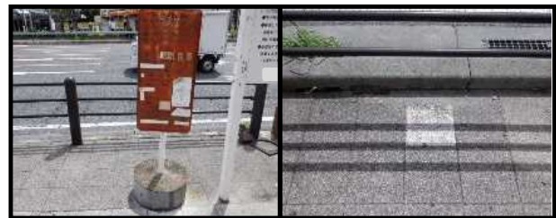
図-3 (左) 老朽化した置き看板 (右) 損耗した路面標示
