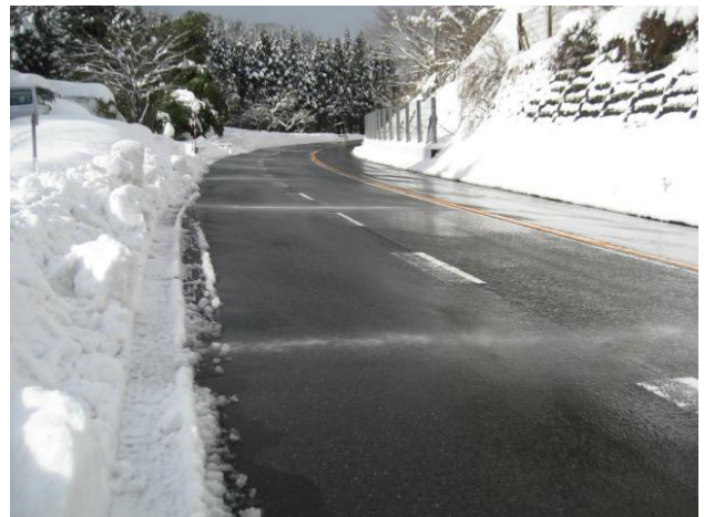
写真-2 散水融雪設備稼働状況
