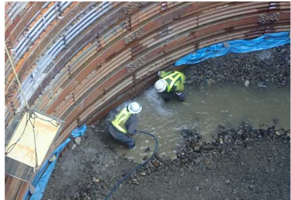
写真-1 P2橋脚の出水状況
