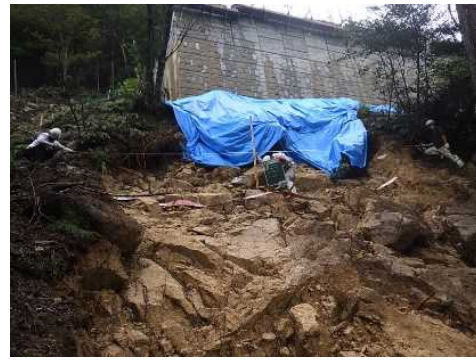
写真 - 4 新7,8号橋間での災害発生(2021年8月)
