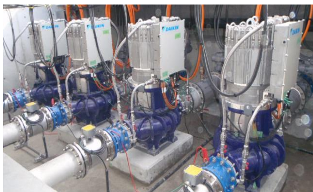
図-2 高安受水場に設置の小水力発電（水車4基並列設置）
