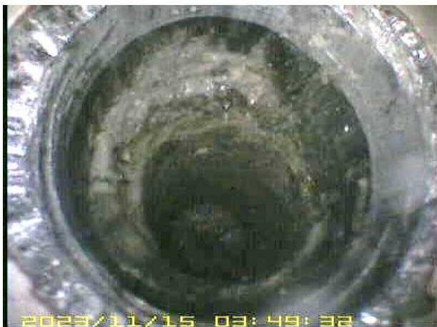
写真-4 削孔内の漏水
