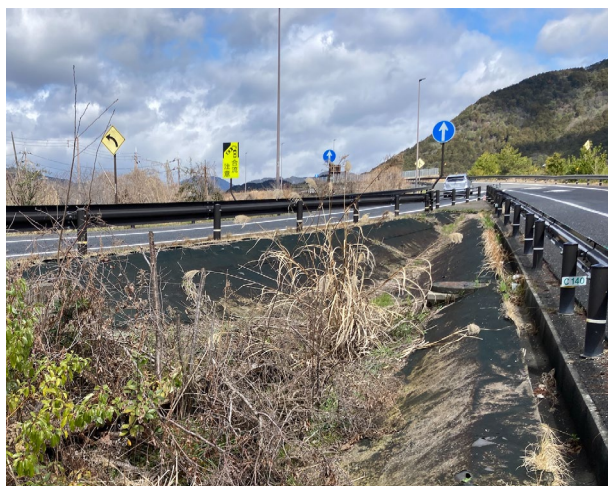
写真-2 植生の防草シート貫通の様子
