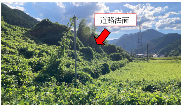
写真-1 国道483号法面の雑草
