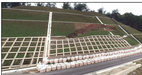
写真-2 切土施工中の県道での法面崩壊
