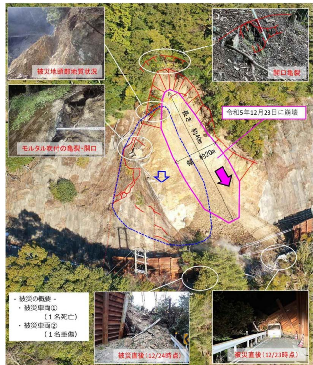
図-2 2023年12月 被災箇所の状況
