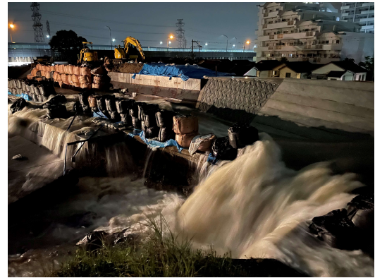
写真-2 被災状況（2023年5月8日 2:30）
