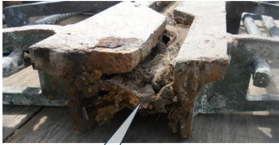
実際に損傷しているのはこの止水機能部のみが多い
