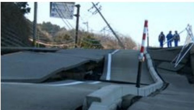
写真 1 能登半島地震による被害状況 国道 249 号（道の駅千枚田付近）
