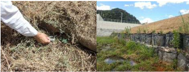
図-7 パイピング(写真左), すべり破壊(写真右)
