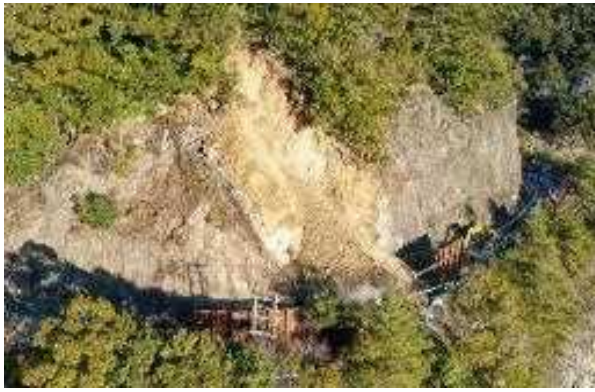
図-2 被災状況（2023年12月24日撮影）
