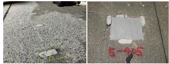
図-5 HJ 部の変状状況 a) と従来の補修状況 b)
