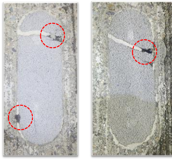
図-9 1年経過後のHJ部の欠損状況
