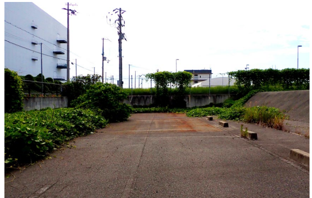
写真-9 臨港道路との接続部がない状況
