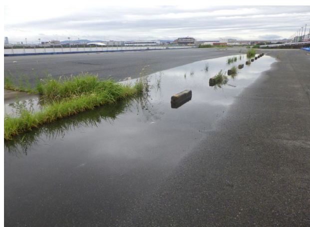
写真-6 舗装の窪みによる局所的な冠水
