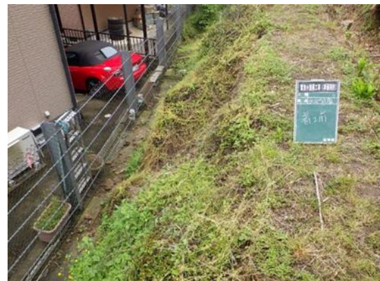
図-2 崩壊した斜面の写真
