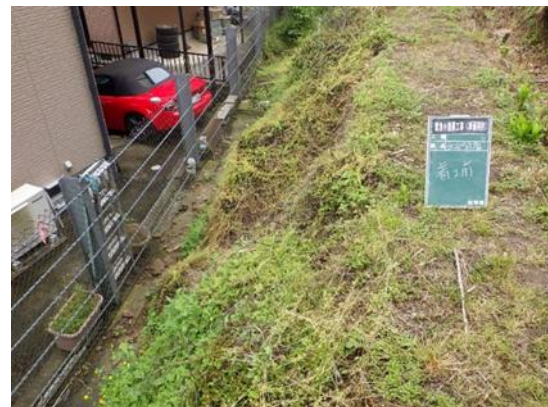
図-2 崩壊した斜面の写真
