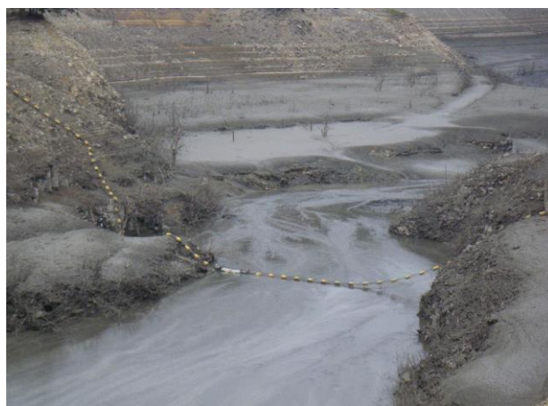
写真-2 永源寺ダム貯水池内堆砂状況
