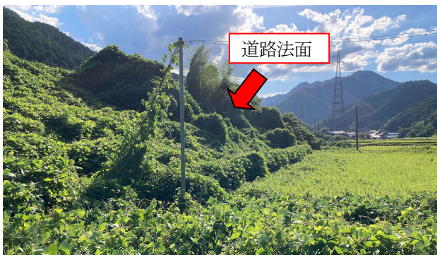
写真-1 国道483号法面の雑草
