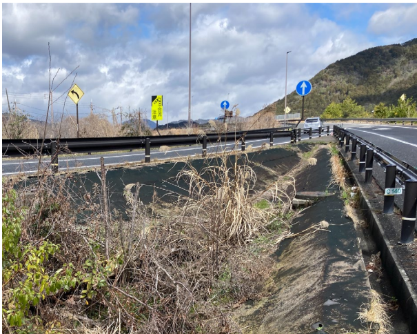
写真-2 植生の防草シート貫通の様子
