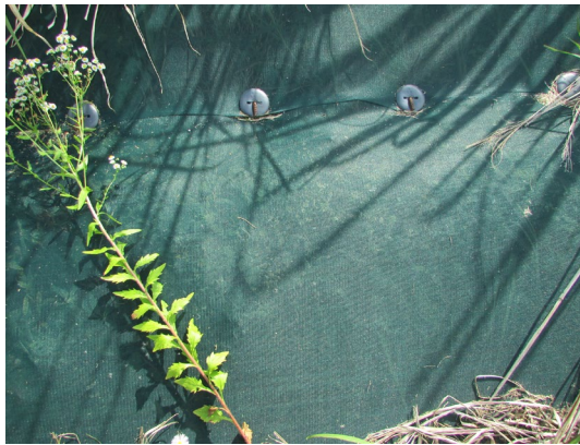
写真-7 和田山JCT ネット表面 6月
