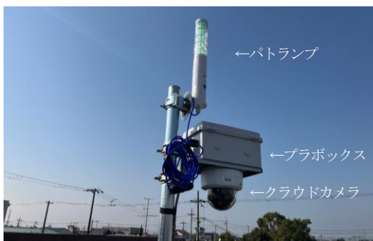
写真 2_ハードウェア設置状況
