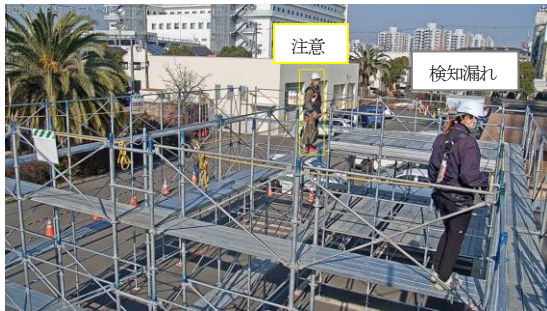
写真7_判定画像（検知漏れ）
