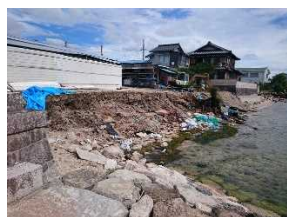
図-1.2 被災した宅地
