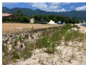
図-1.1 発生した浜崖
