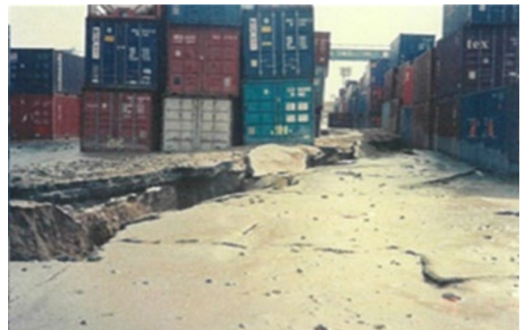
写真-1 液状化したコンテナヤード
