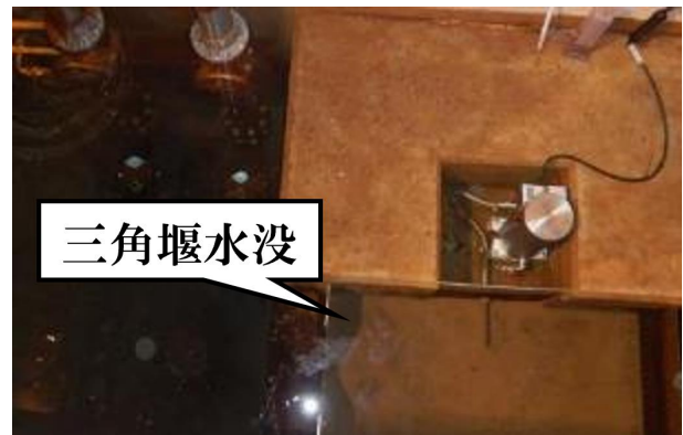
写真-2 水没した三角堰
