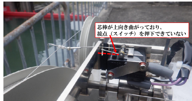
写真-1 修繕前のフロート式水位計状態
