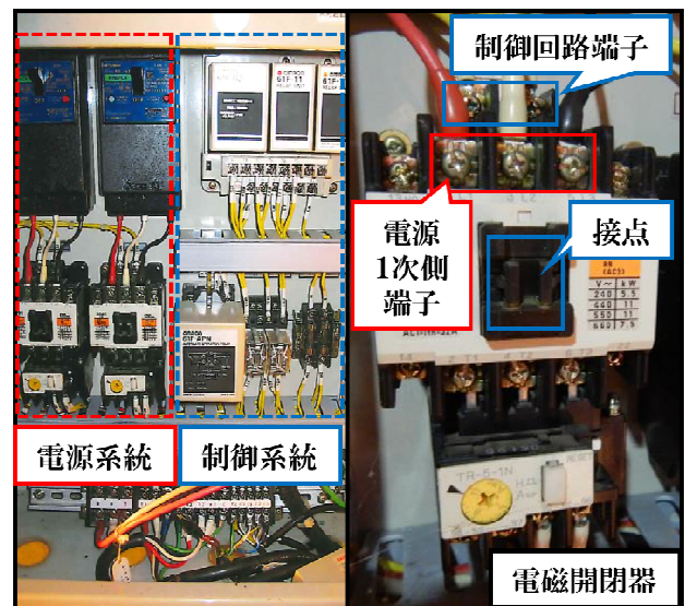
写真3 制御盤内（左）と電磁開閉器（右）
