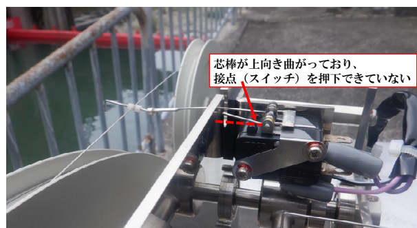
写真-1 修繕前のフロート式水位計状態
