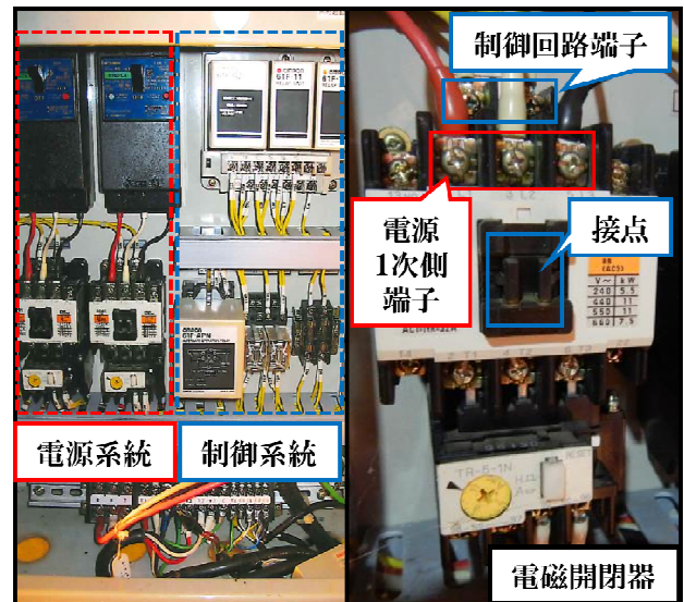
写真3 制御盤内（左）と電磁開閉器（右）
