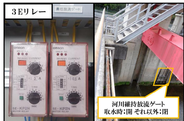
写真4 3Eリレー（左）と河川維持放流ゲート（右）
