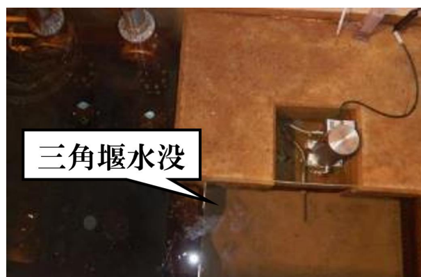
写真-2 水没した三角堰
