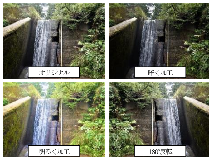
写真-10 堰堤のひび割れ(変状レベルc)の学習データの例
