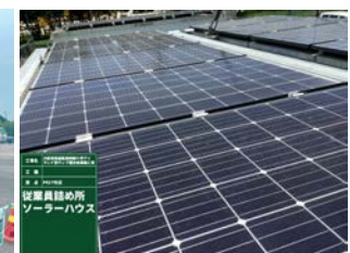
図-12 ⑥ソーラーパネル(天井)
