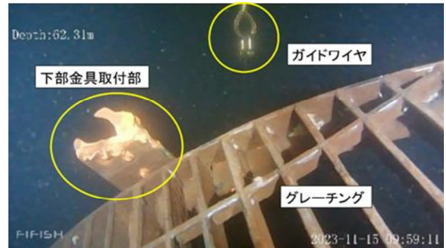
図-3 損傷した下部金具取付部の状況
