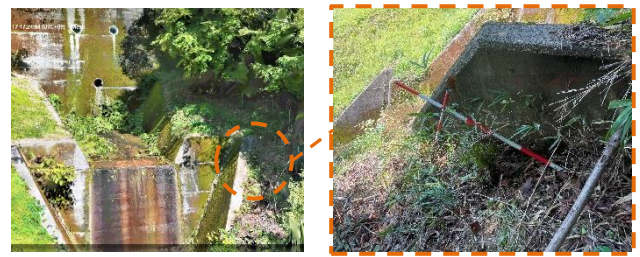
写真-6 3Dモデルで把握できない側壁護岸の吸出し状況 (左:3Dモデル 右:徒歩点検の写真 UAVで護岸裏面が撮影できない現場であり、損傷を把握できない)
