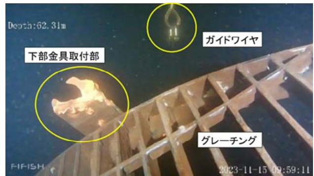
図-3 損傷した下部金具取付部の状況
