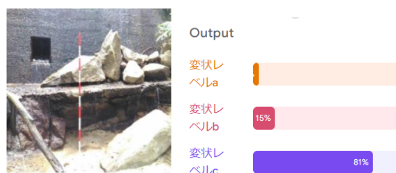
写真-9（左：堰堤が洗堀しており、人間の判定で変状レベルcとした画像 右：モデル判定結果、変状レベルcの割合が最も高いため、この場合は「一致」とみなす）
