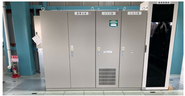
図-6 閘門上流側操作室に設置した無停電電源装置
