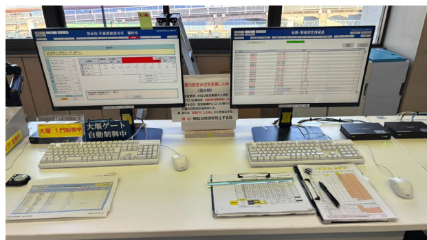
図-3 淀川大堰放流操作装置（左：現用・右：予備）
