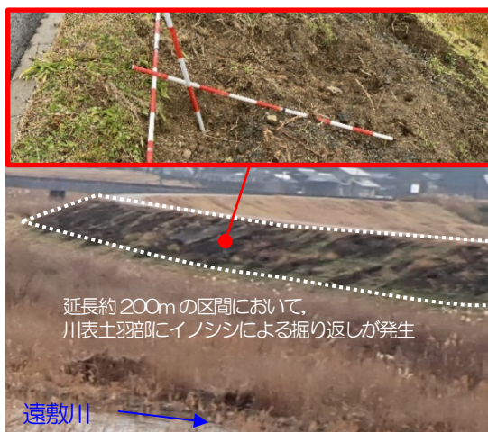
写真-1 遠敷川におけるイノシシの掘り返し被害 (遠敷川左岸 0.5k 付近)
