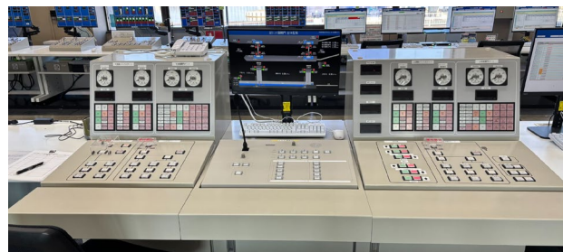
図-4-1 淀川大堰閘門 遠方手動操作卓（中央部は放送卓）
