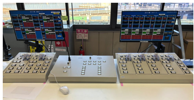
図-4-2 淀川大堰 遠方手動操作卓（中央部は放送卓）
