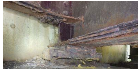
写真-4 I橋の路面状況と伸縮装置の劣化状況 (A1側)
