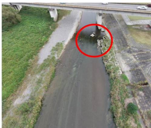
図-6 護床ブロック(2tサイズ)の欠損
