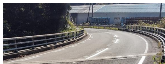
写真-11 N橋の床版補修実施から約7年経過後の路面状況
