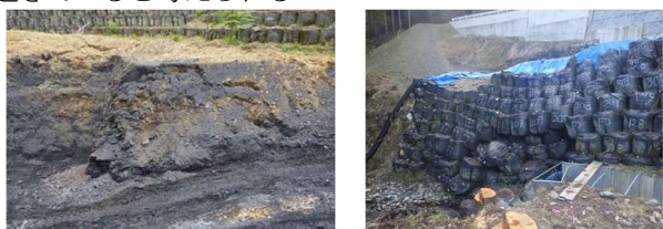
図-5 現場の変状の様子
