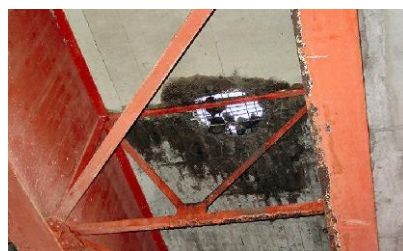
写真-1 床版の損傷事例（コンクリート床版の抜け落ち） 2
