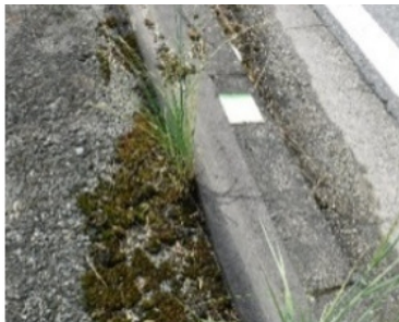
図-2 雑草繁茂状況（シールタイプ）
